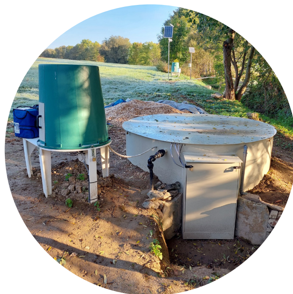
Figura 1: Un exemplu de unitate de bioreactor semi-operațional instalat.
